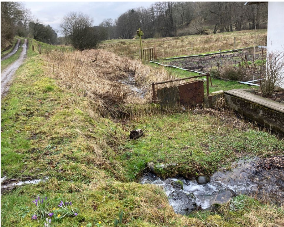
Figur 3. Udløbet fra røroverkørslen er i bunden af billedet.
